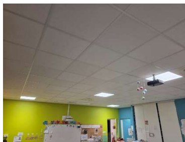
Nouveaux luminaires dans l'école
